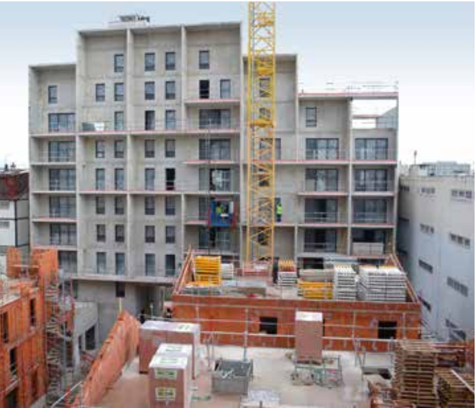
MISE HORS D'AIR BÂT. C
